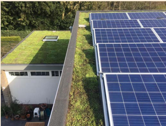
5.15 Zonnepanelen op groen dak achter daklijst
